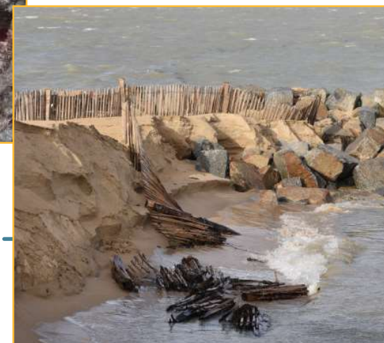
Dégâts sur ganivelles observés à la Pointe de Montmartin -----
